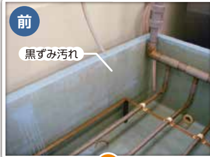
殺菌槽・洗浄槽
